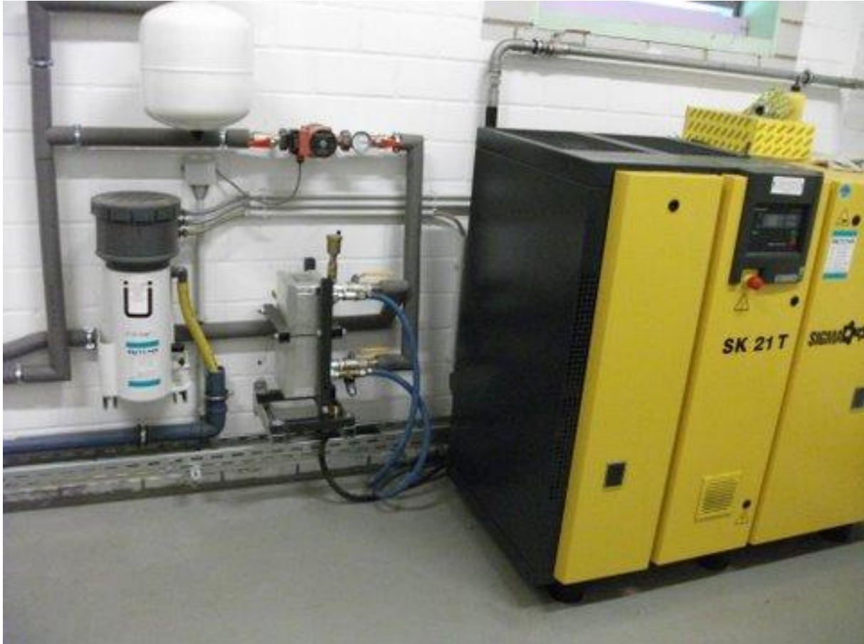
Bild 5: Wärme vom Schraubenkompressor wird genutzt, das sind 72 kWh pro Tag
